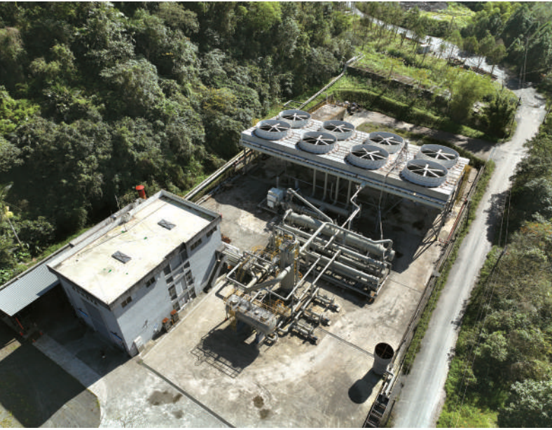
宜元4.2MW地熱電廠全貌（將捷集團提供）
