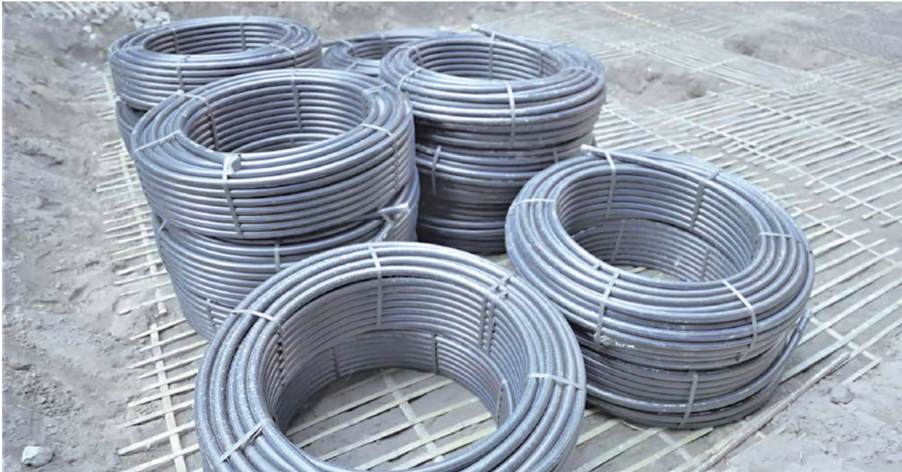
堆疊在旁的管線
