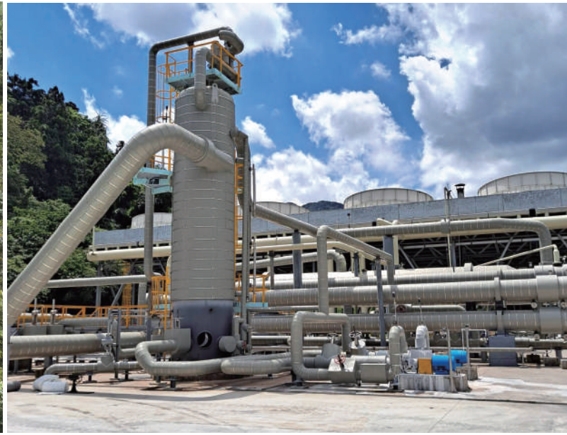
清水地熱電廠4.2Mwe電廠設施（將捷集團提供）
